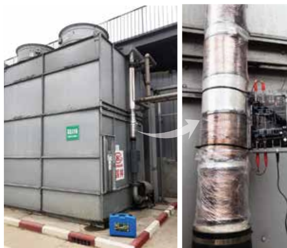
Vulcan S25 安装在冷却塔进水口
