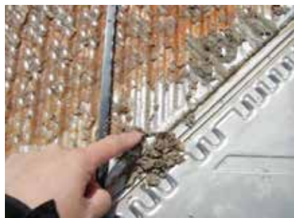
板式换热器上的水垢变软
