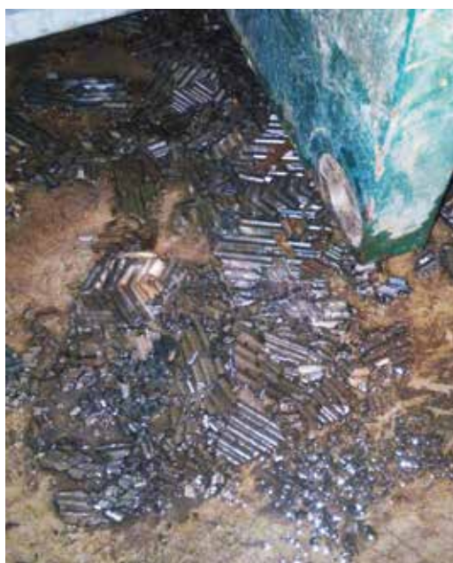
未使用沃肯, 供暖结束后拆卸清理的水垢。
