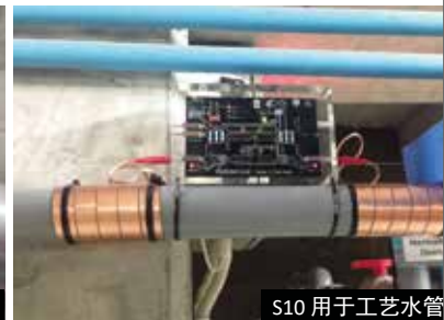
管道绝缘层覆盖脉冲带
