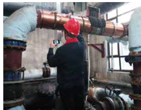
安装在进水母管上的 Vulcan S250
