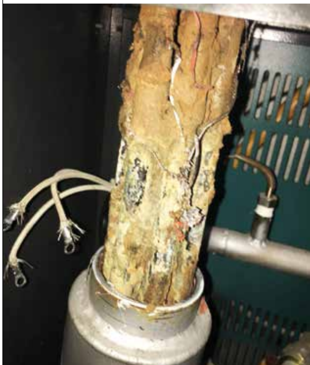
三年未作处理的换热器结垢情况
