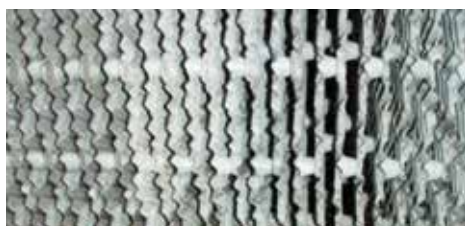
在安装沃肯(Vulcan)之前: 冷却塔的內部
