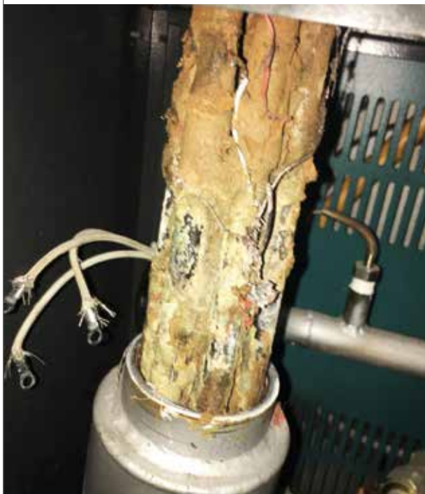
三年未作处理的换热器结垢情况
