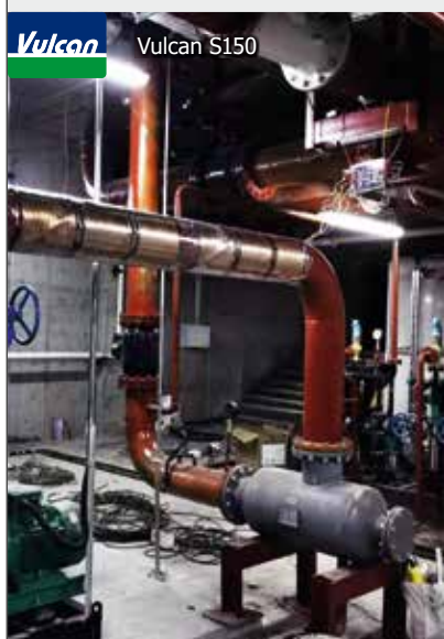
商业换热供暖系统
