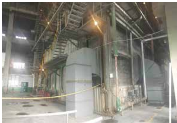
Vulcan S100 安装在二号锅炉进水管上，安装20天后，给水母管已经降压0.12MPa
