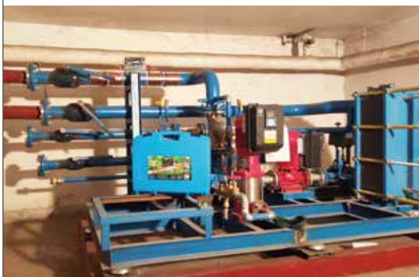
Vulcan S25安装在129号楼供暖换热机组入水端
