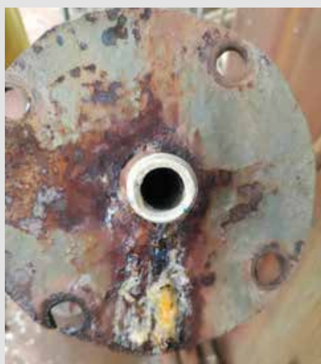
沃肯(Vulcan)安装前脱硫塔的结垢情况
