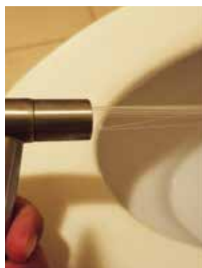
安装前：用来冲洗卫生间的水枪已经被水垢堵塞了大约2/3的部分
