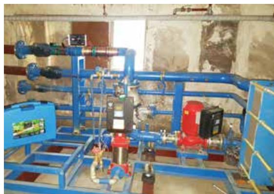
Vulcan S25安装在131号楼供暖换热机组入水端
