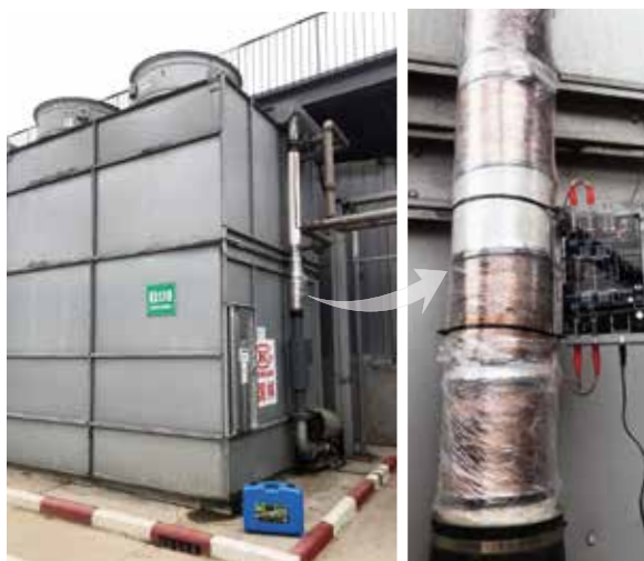
Vulcan S25 安装在冷却塔进水口
