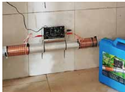
Vulcan 5000安装在当代中国研究所热力站生活热水系统，为解决燃气锅炉和热水水箱结垢问题
