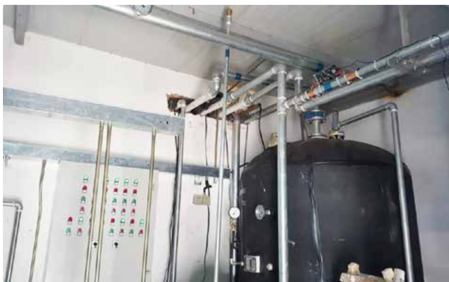
Vulcan 5000 安装在酒店进水总管路
