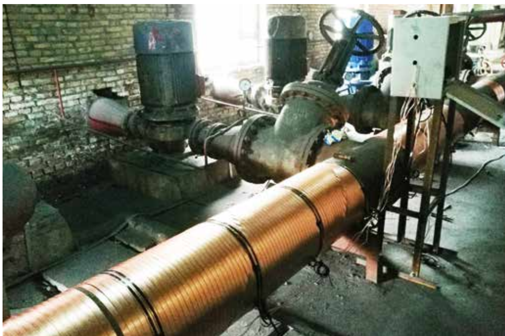
Vulcan S500 解决循环冷却水系统结垢严重的问题，并且停止了软水器的使用。
