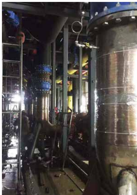
Vulcan S500 安装在中央空调循环水系统管道
