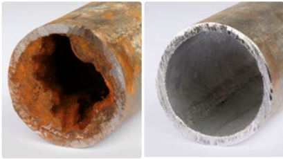
Hệ thống đường ống
