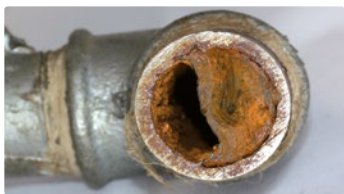
Ống nước bị đóng cặn
