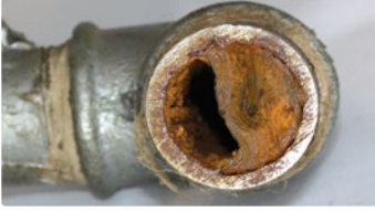
Boru içindeki kireç birikmeleri/tortuları
