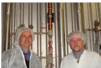
Vulcan installerat i en livsmedelfabrik
