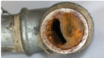
Rör med avlagringar
