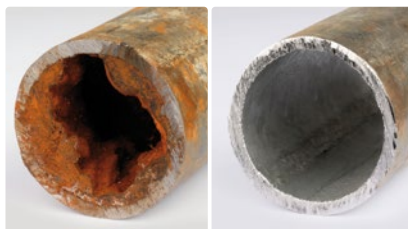
Rör med avlagringar
