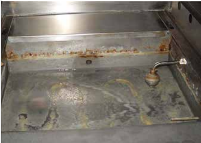
Vulcan kurulumundan önce pişirme kazanında sert kireç ve yüzeyinde aşınma çizgisi mevcut.
