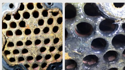
Tubo — intercambiador de calor
