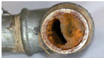
Tuyau présentant des dépôts de calcaire
