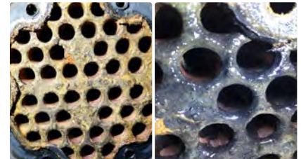
Faisceau tubulaire d'un échangeur de chaleur
