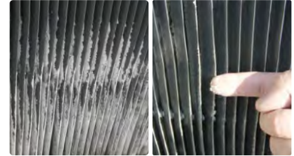
Grille d'une tour de refroidissement
