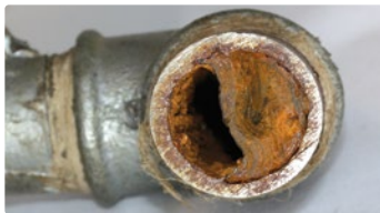
Rør med kalkophobning
