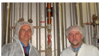
Vulcan installeret på en fødevarerfabrik
