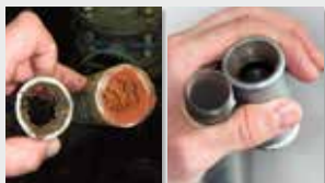
Sistema de tuberías
