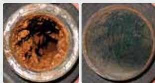
Биослой в трубопроводе
