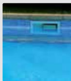
游泳池的排水管道
