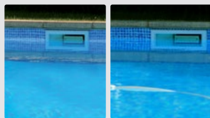
游泳池的排水管道
