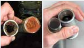
Sistema de tuberías
