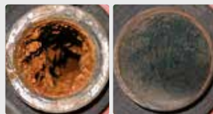
Биослой в трубопроводе
