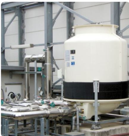
Tour de refroidissement
