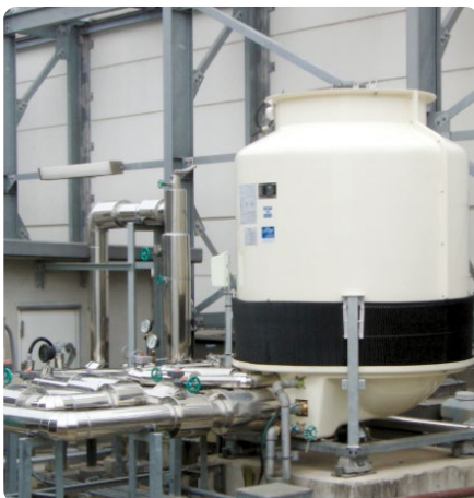
Torre de refrigeración
