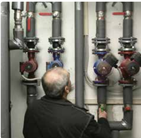
Circuito de tuberías en un edificio de apartamentos
