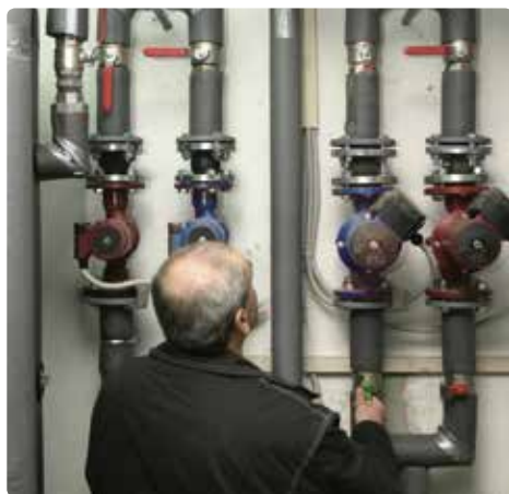
公寓大楼中的管道系统
