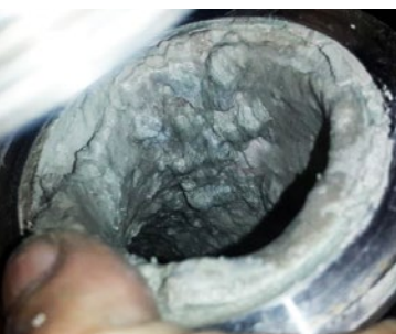
Avant l'installation de Vulcan : Le tuyau était recouvert de dépôts de calcaire.
