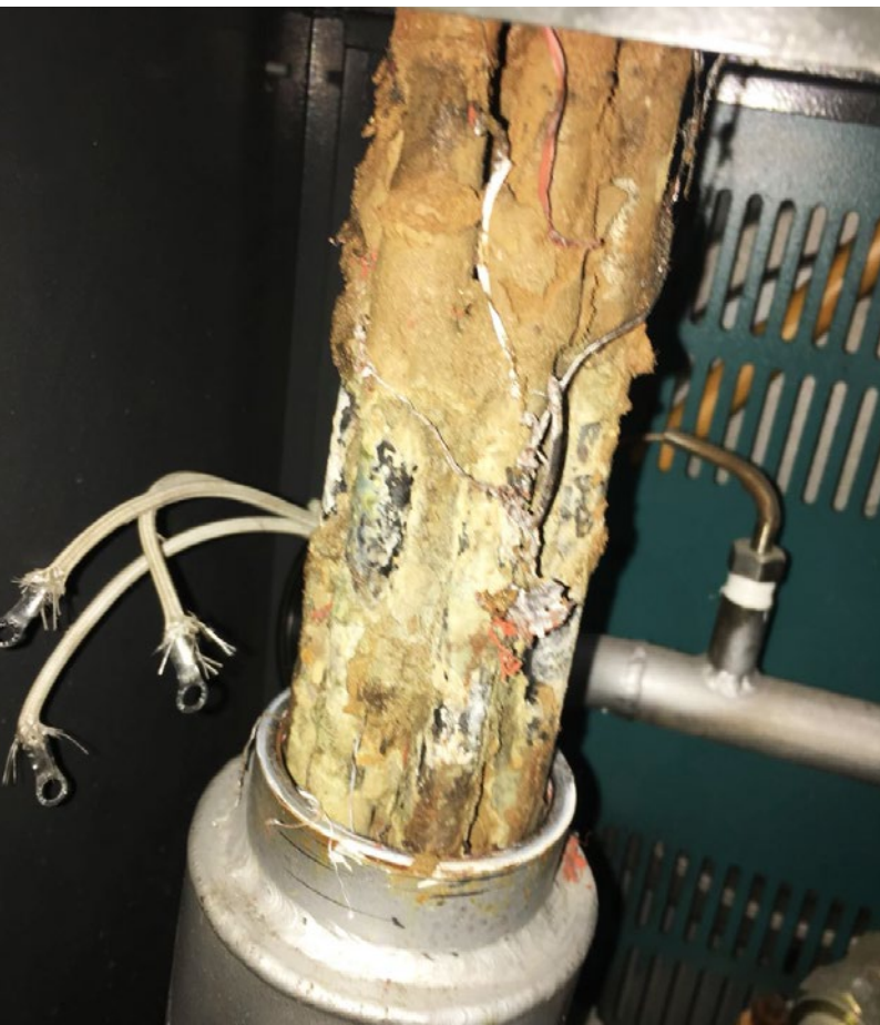
Intercambiador de calor sin mantenimiento por 3 años.
