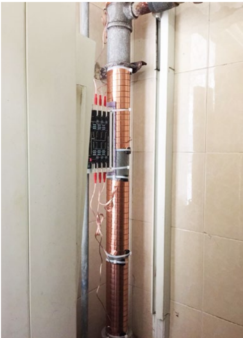
Vulcan S100 instalado en la tubería principal de agua
