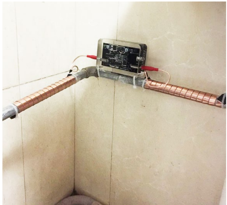
Vulcan 3000 instalado en la tubería más pequeña del dormitorio
