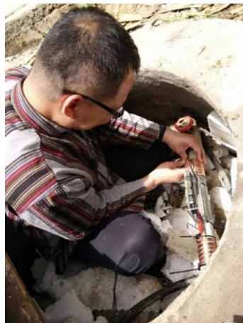
Instalado por el distribuidor de CWT: Jiangsu Xinriyuan
