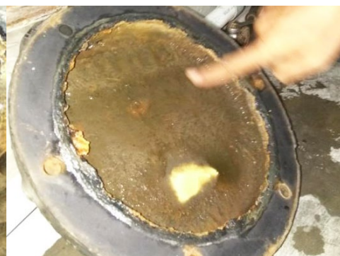
Interior del intercambiador de calor. El recubrimiento del condensador ha perdido toda la escala que tenía antes. (El punto de luz en la parte inferior es reflejo de la luz)
