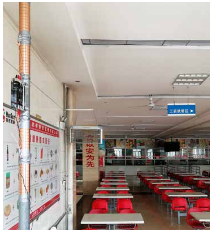
El Vulcan S25 fue instalado para solucionar los problemas con las incrustaciones en el comedor.
