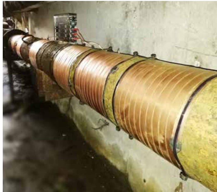
El Vulcan S150 fue instalado en la tubería principal para el edificio de oficinas y el dormitorio.
