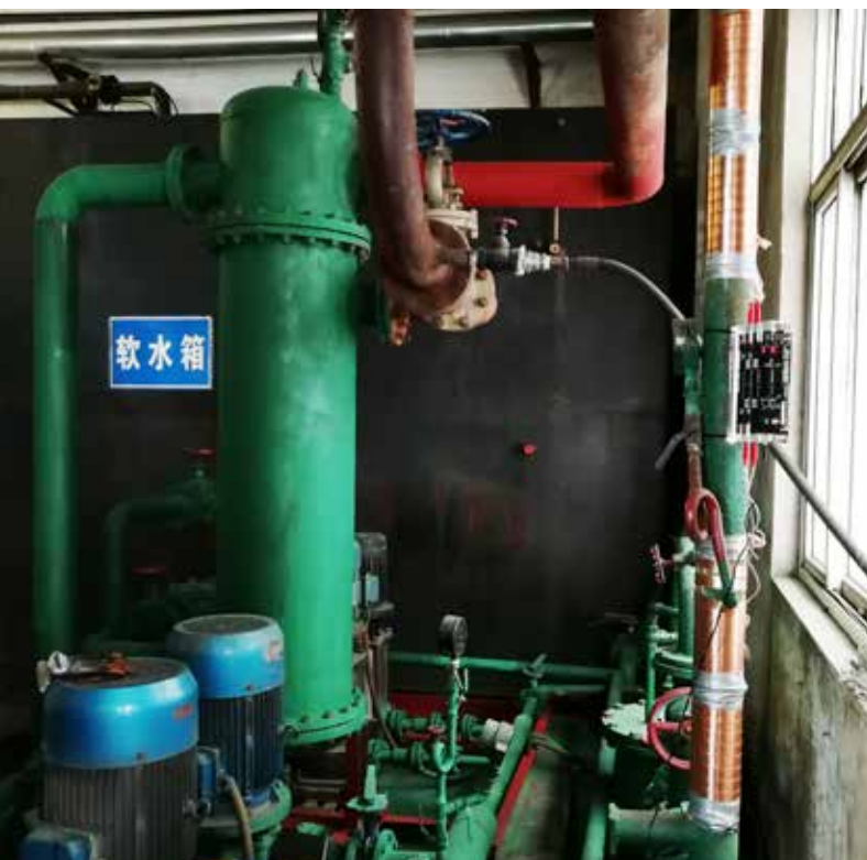
El Vulcan S25 fue instalado en la tubería principal en la sala de calderas.
