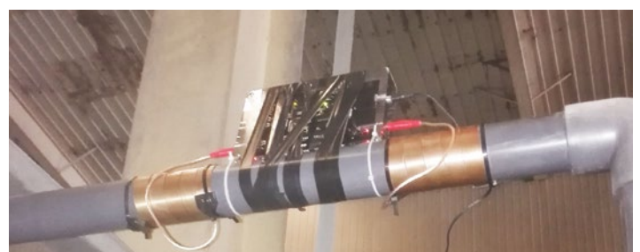
Vulcan S10 instalado antes de la membrana de ósmosis inversa.
