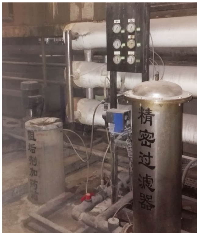
Equipo de procesamiento de agua pura.
