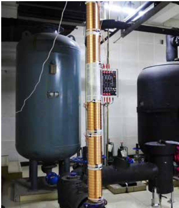
Vulcan S100 instalado en el hotel de Pekín, China
