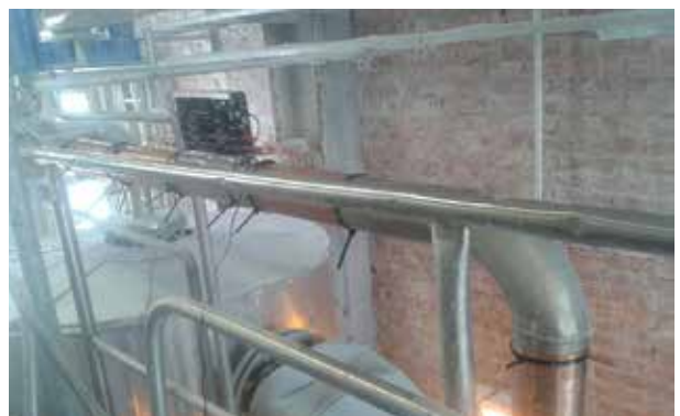
Instalación de Vulcan S100 para la cal del horno
