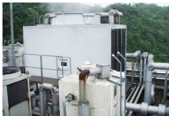
Torre de refrigeración en el techo de la planta
