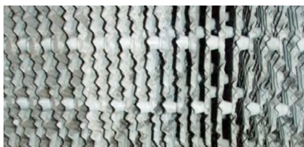
Antes de instalar Vulcan: interior de la torre de refrigeración.
