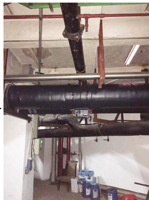
Paso 2: Se envolvió la tubería con material aislante y luego se instaló la unidad Vulcan S350
