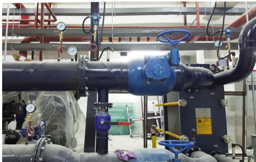
El Vulcan S150 se instaló en el sistema de calefacción en la zona baja de la estación para el intercambio de calor.
