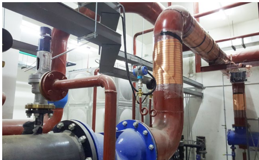
Vulcan S350 se instaló en el sistema de calefacción en la zona alta de la estación para el intercambio de calor.
