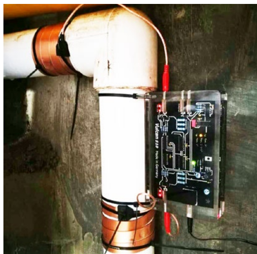
Vulcan S10 instalado en la tubería principal de salida de agua.
