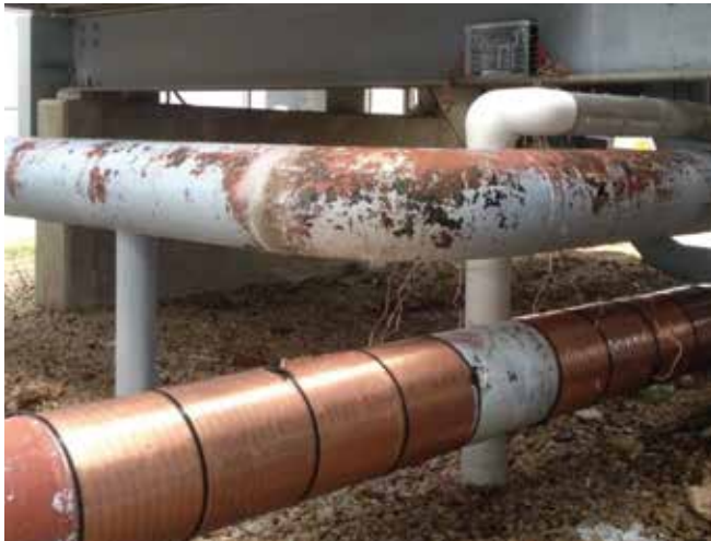
Vulcan S250 instalado en una línea de 10 pulgadas de diámetro que alimenta las torres de enfriamiento gemelas (CT-1 y CT-2)
