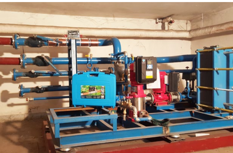
Vulcan S25 se instaló en la entrada de agua del sistema de calefacción del edificio 129.
