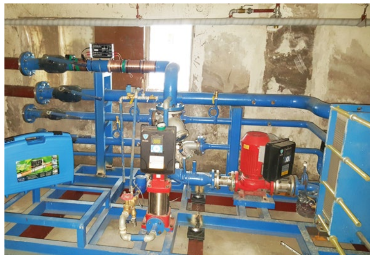
Vulcan S25 se instaló en la entrada de agua del sistema de calefacción del edificio 131.
