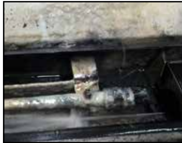
7 de febrero: Observación visual de la máquina 1 antes de instalar el Vulcan. La pared y las boquillas tienen incrustaciones y bacterias.
