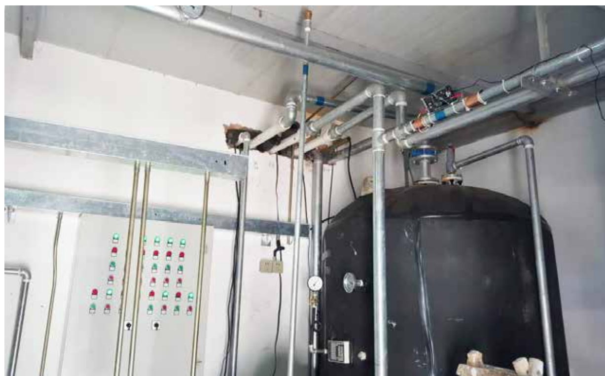
Vulcan 5000 fue instalado en la tubería principal de agua del hotel
