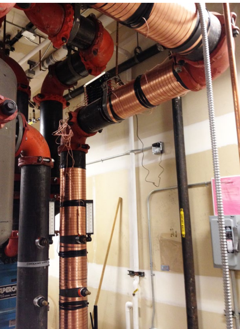
Vulcan S250 处理银行内的冷却塔。
