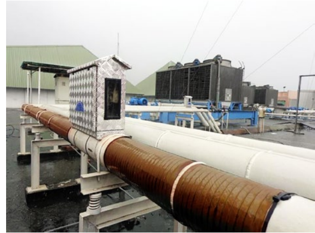
Vulcan S500位于铝箱内, 安装在购物商圈 Supermal Karawaci的一个冷却塔主管上。
