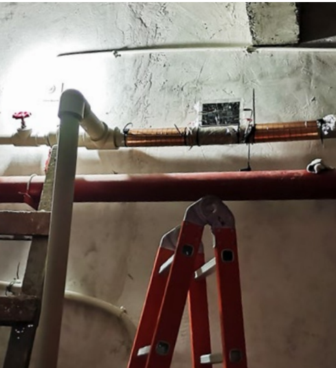
Vulcan S10 安装在酒店进水总管路
