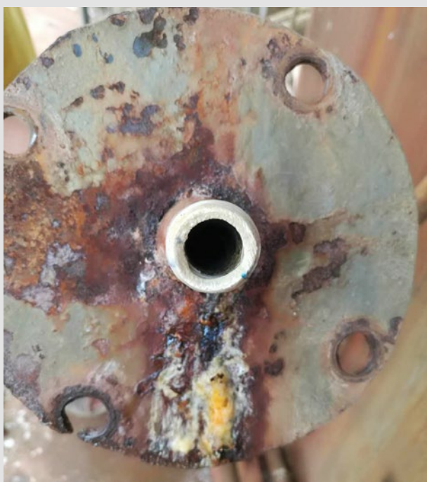
沃肯(Vulcan)安装前脱硫塔的结垢情况
