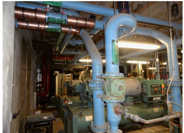
安装在双制冷机上的Vulcan S100装置
