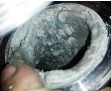
在Vulcan安装之前：管道里堆满了水垢
