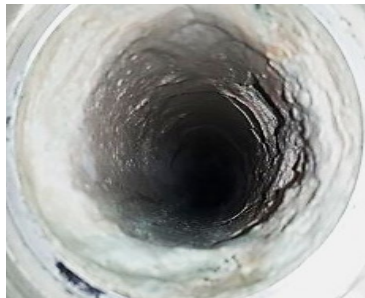
Vulcan 5000 安装2周后，水垢变得更加柔和并且开始脱落
